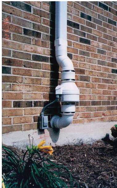
Ventilador y tubería de ventilación típicos
