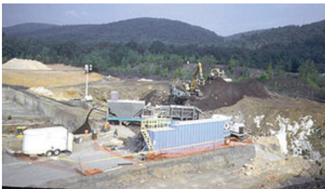
El suelo contaminado mezclado con cemento en un molino de barro se esparce en el suelo como pavimento.
