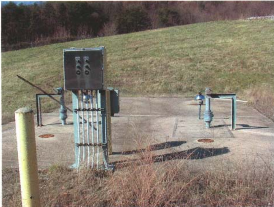
Photo 19- OUI Collection Pump Station
