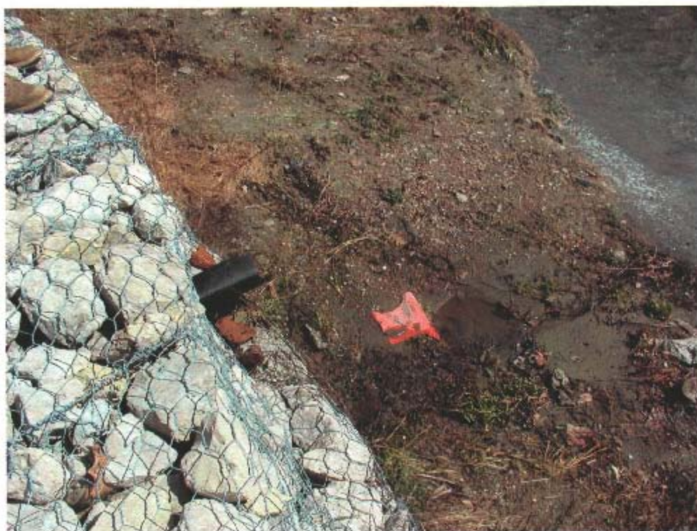
Photo 37- Effluent Discharge Point
