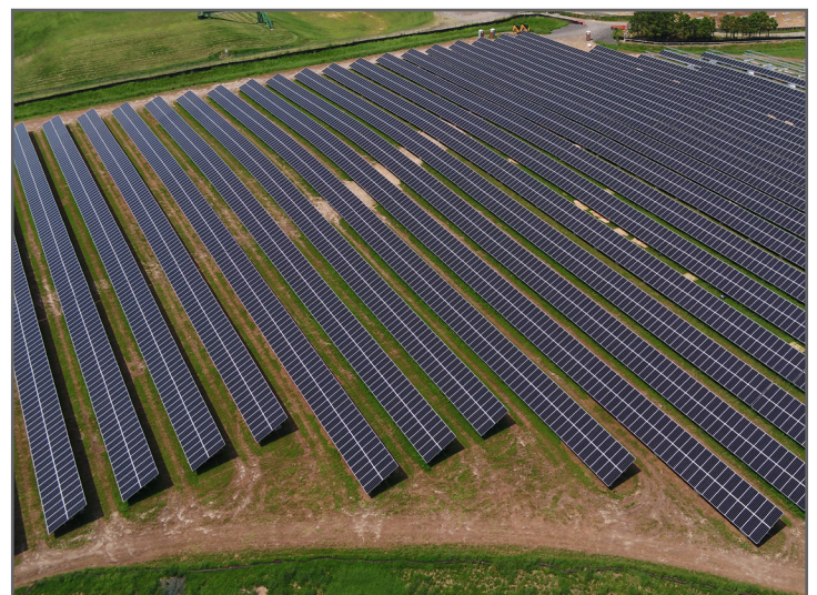
Una matriz solar en el sitio Superfund de Ciba-Geigy Corp. En Toms River, New Jersey.
