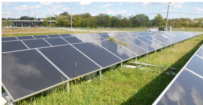
Figure 45. Solar panels at the E.I. Du Pont De Nemours & Co., Inc. site.
