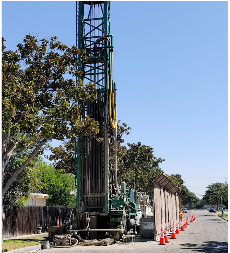
La perforación e instalación de pozos en el sitio Superfund de la Cuenca Norte del Condado de Orange.
