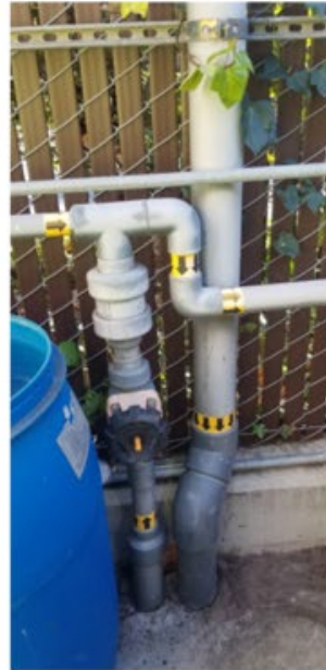
Intersil GWET Influent & Effluent Manifolds
