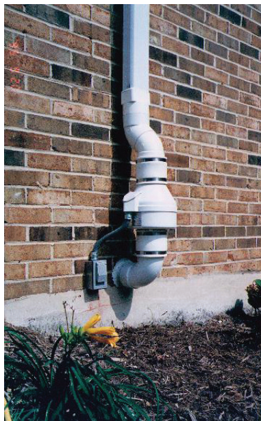
Ventilador y tubería de ventilación típicos
