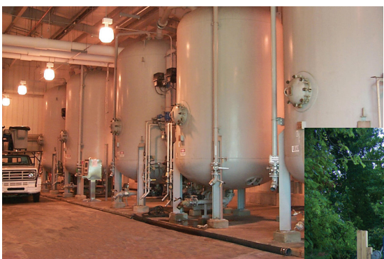
Sistema de tratamiento de aguas subterráneas grande con cinco tanques de GAC.
