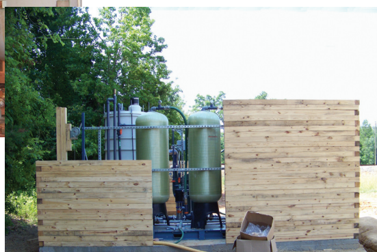
Sistema de tratamiento de aguas subterráneas pequeño con dos tanques de GAC.
