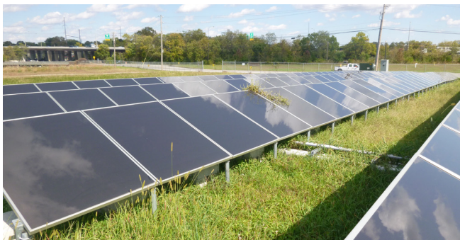
Figure 16. Solar panels at the E.I. Du Pont De Nemours & Co., Inc. site.
