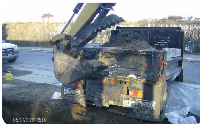
El suelo excavado y contaminado fue retirado del predio para desecharlo en forma segura.
