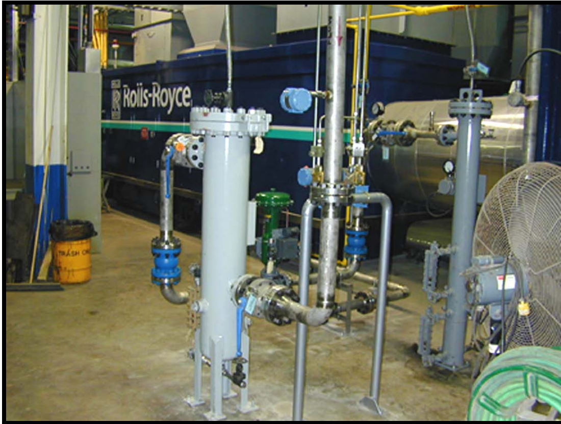
5 MW Rolls-Royce Turbine
